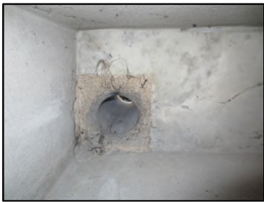
Photo N° 1237 AMIANTE CIMENT - -PLACARDS TECHNIQUES +3 Plafonds Ventilation haute (Fibres- ciment)
